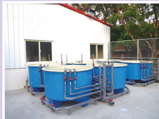
完成設備安裝試運轉申報外觀
